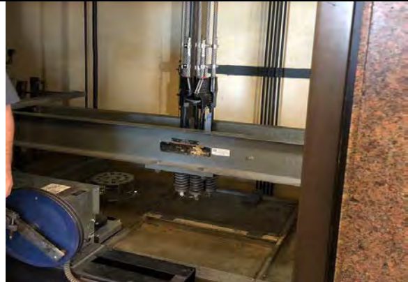
El Monte Courthouse - LA - Elevator
