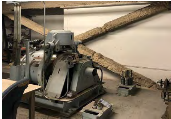
Van Nuys West Courthouse - LA - Elevator
