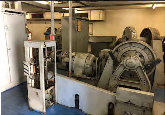
El Monte Courthouse - LA - Elevator
