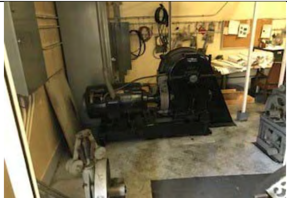
El Monte Courthouse - LA - Elevator
