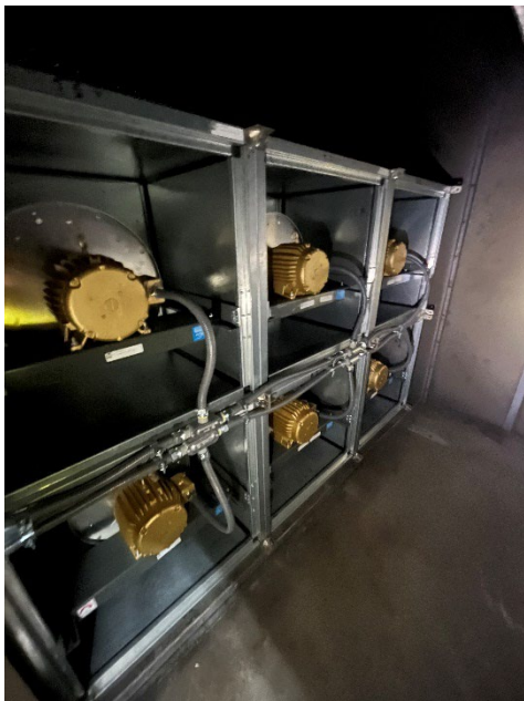
West Justice Center – AHU Fan Wall
